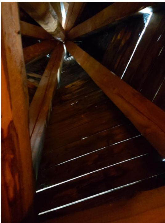
Foto til venstre: Sprekkdannelser i tårnet.
